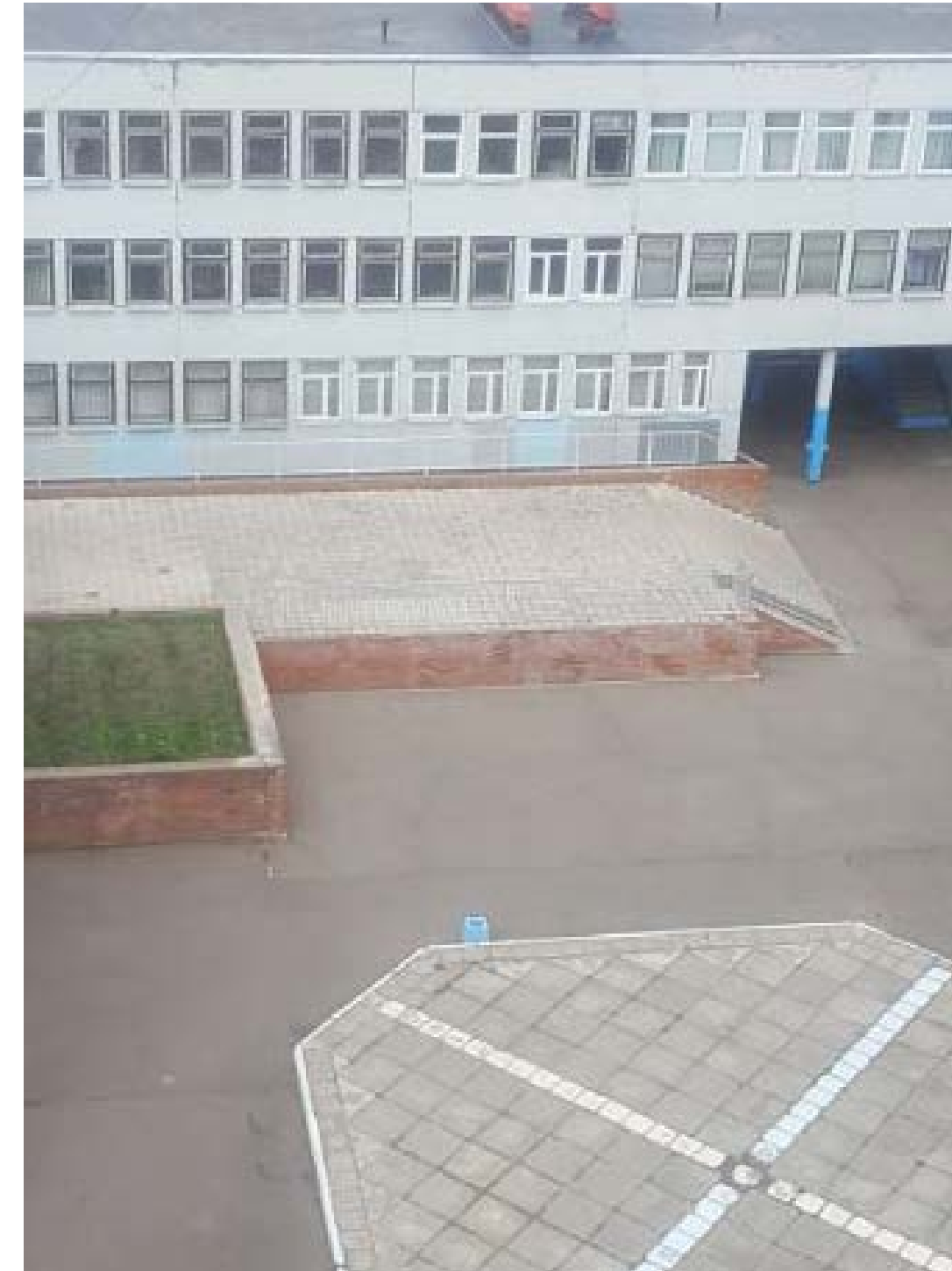
Лестница с торчащим каркасом
